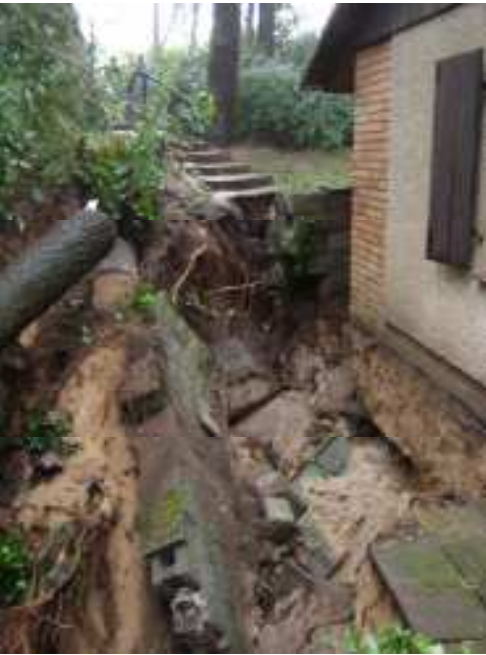
Besonders stark betroffen war ein Haus am Üdersee, das abzurutschen drohte.
